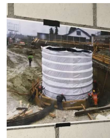
長期蓄熱槽 (建設時)
